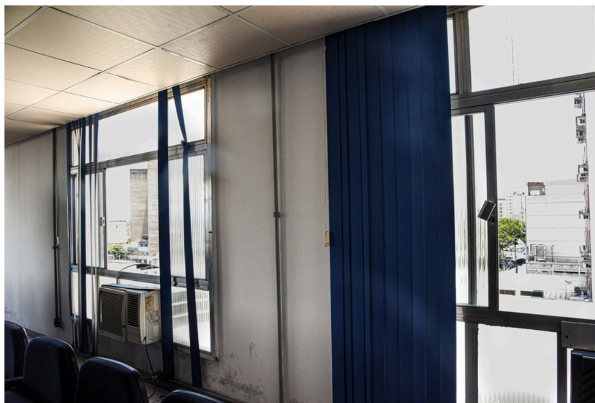
Janelas abertas da Gerência Caxias mostram necessidade de troca de aparelhos. .
